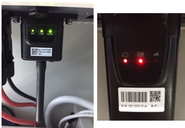
Figure 31 - État final des LED
