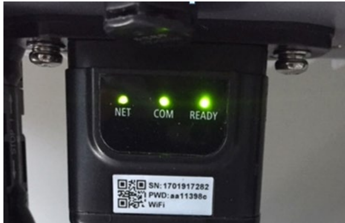
Figure 43 – État final des LED
