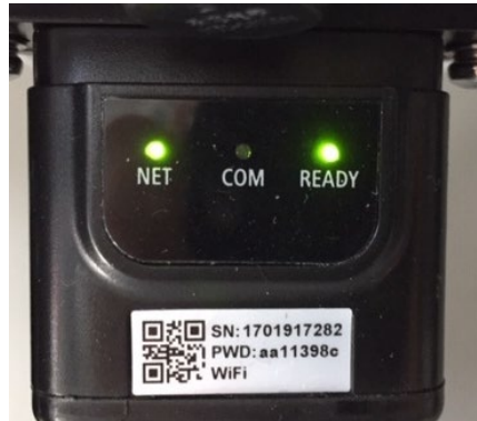
Figure 50 – État de communication irrégulière entre l'onduleur et l'adaptateur
