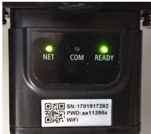
Figure 44 – État de communication irrégulière entre l'onduleur et l'adaptateur
