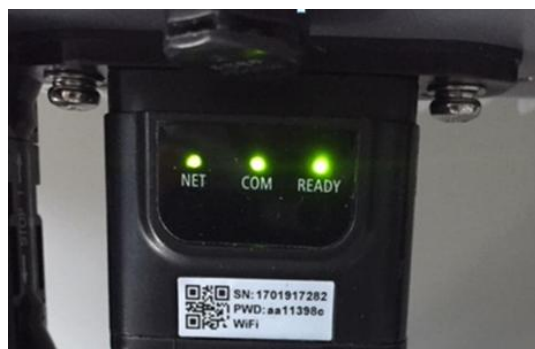
Abbildung 109 - Endzustand der LEDs
