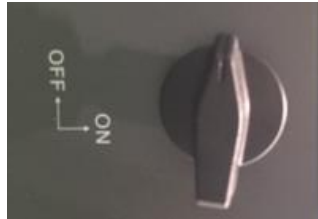
Abbildung 70 - Trennschalter für Photovoltaikanlagen
