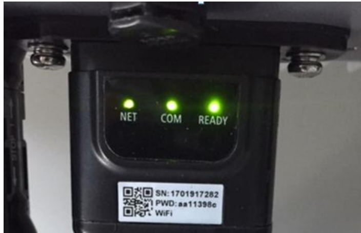
Abbildung 103 - Endzustand der LEDs
