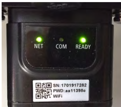
Figura 90 - Stato di comunicazione irregolare tra inverter e adattatore
