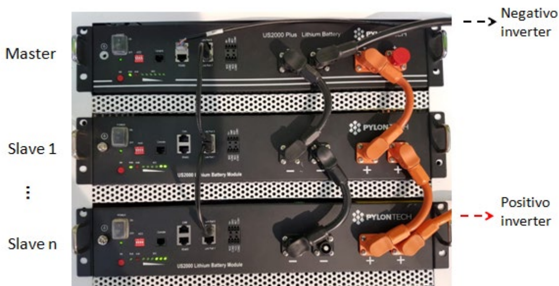
Figura 11 - Parallelo di tre batterie Pylontech
