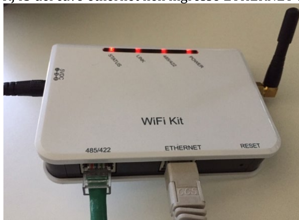
Figura 136 – Cavo ethernet connesso al datalogger
