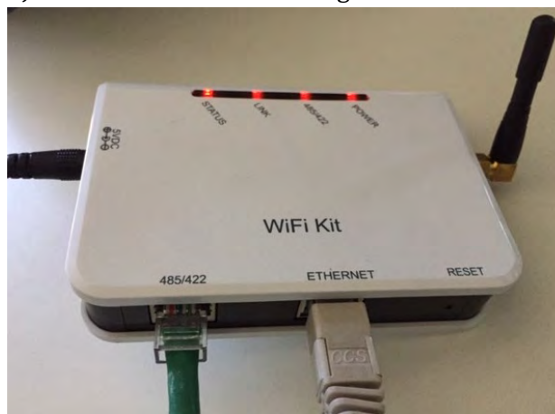
Figura 82 – Cavo Ethernet collegato al datalogger
