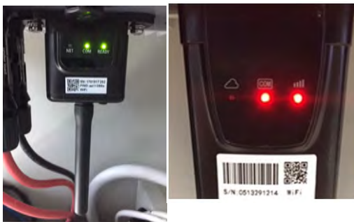
Figura 5-51 - Stato iniziale dei LED
