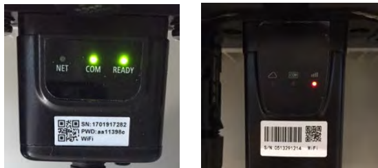
Figura 5-54 - Stato di comunicazione irregolare tra Wi-Fi e server remoto
