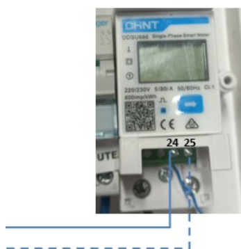
Abbildung 29 – PIN-Anschlüsse des ZSM-METER-DDSU-Messgeräts
