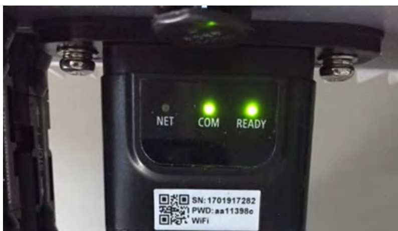
Figura 88 - Estado inicial de los LED
