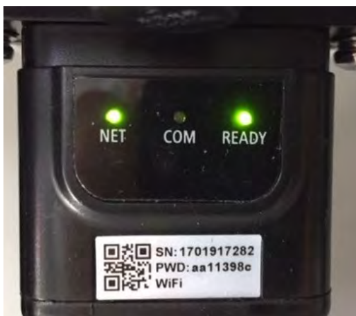
Figura 90 - Estado de comunicación irregular entre inversor y adaptador
