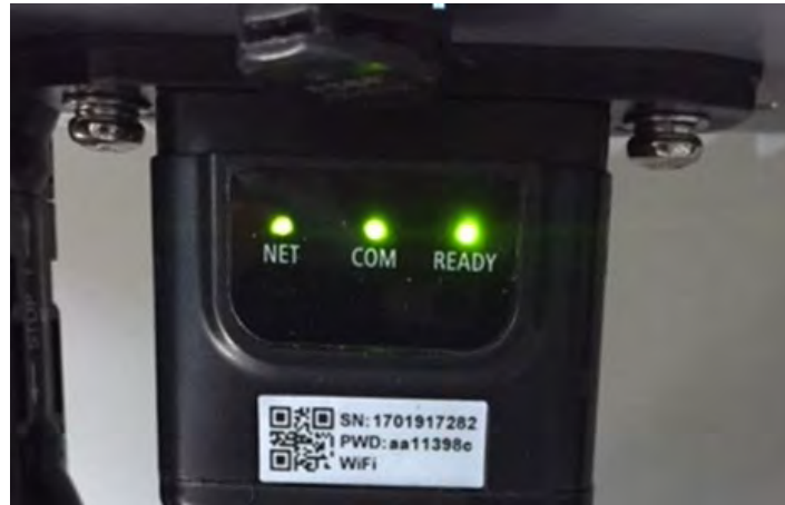
Figure 89 – État final des LED
