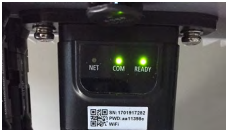
Figure 88 – État initial des LED
