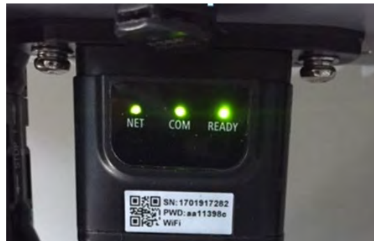
Figure 95 - État final des LED
