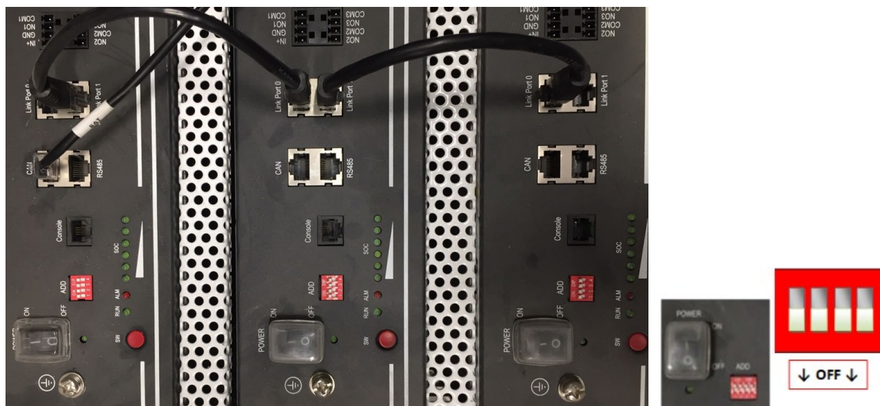
Figura 11 – Conexión de comunicación entre tres baterías Pylontech
