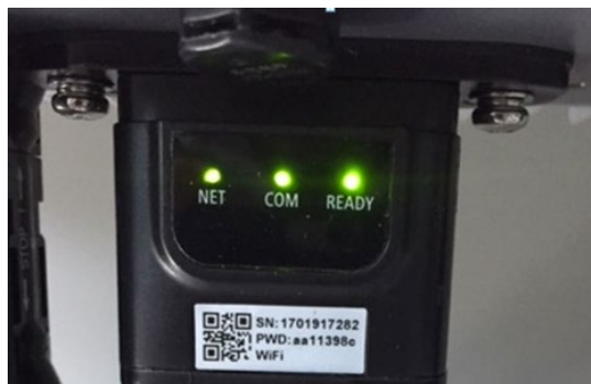
Figura 114 - Estado final de los led
