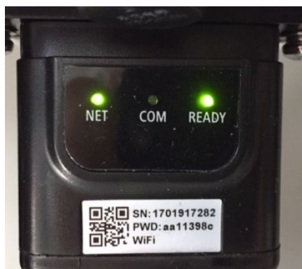
Figura 115 - Estado de comunicación irregular entre inversor y tarjeta
