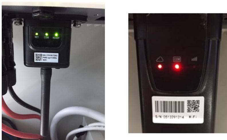
Figura 98 - Estado final de los led
