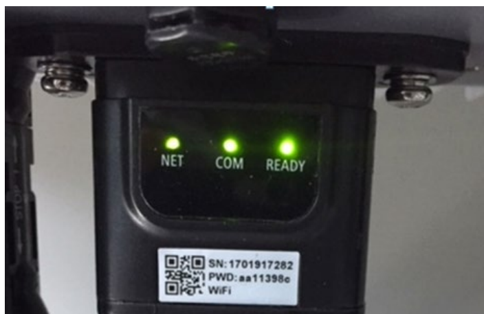
Figura 109 - Estado final de los led
