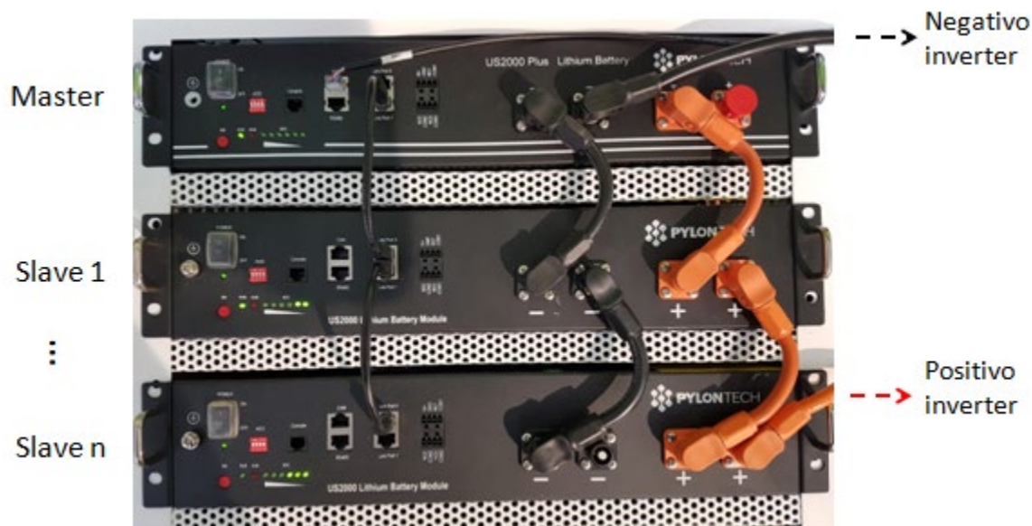
Figura 10 – Paralelo de tres baterías Pylontech
