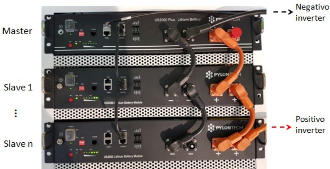
Figure 10 - Parallèle de trois batteries Pylontech
