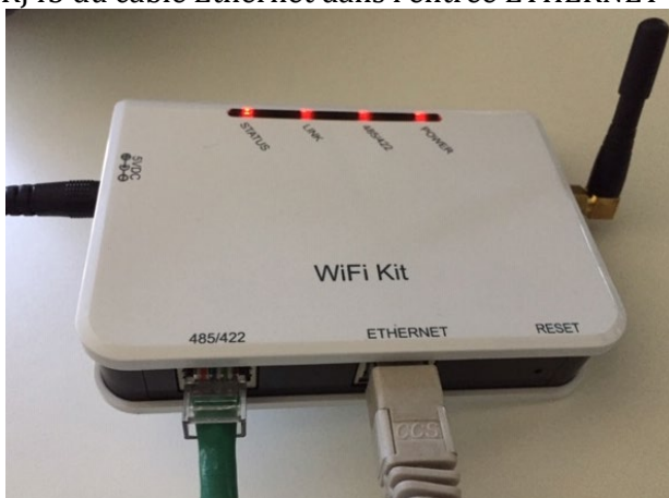
Figure 120 – Câble Ethernet connecté au datalogger
