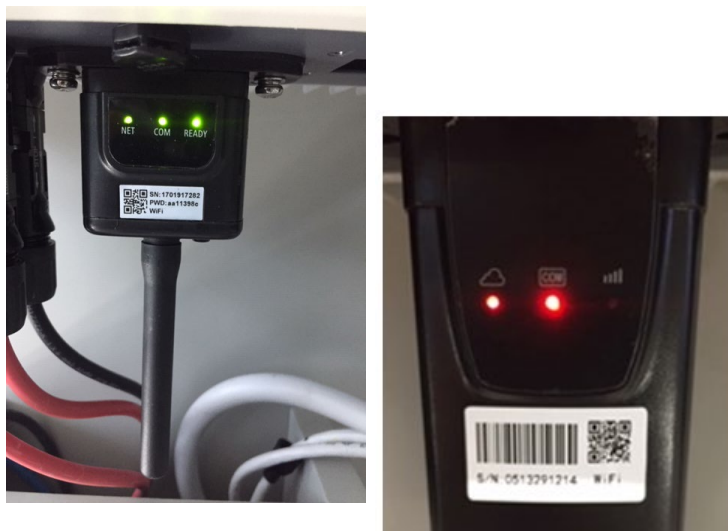
Figure 120 – État final des led
