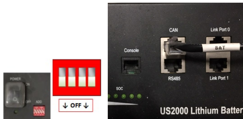
Figure 17 – Connexion du câble de communication à la batterie Pylontech
