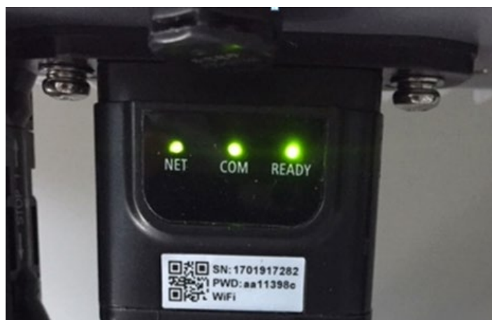
Figure 132 – État final des led
