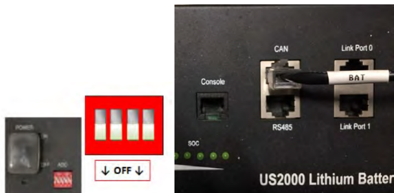
Рисунок 19 – Підключення комунікаційного кабелю до акумуляторної батареї Pylontech
