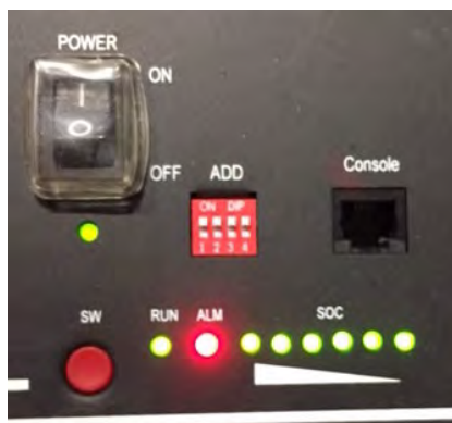
Рисунок 113 – Стан батареї після встановлення перемикача POWER у положення ON та натискання кнопки SW
