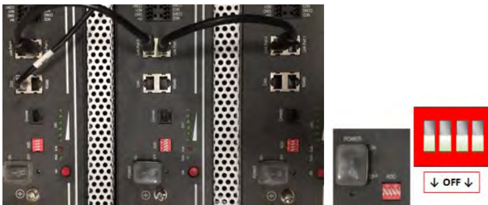
Рисунок 16 – Підключення кабелю між трьома акумуляторами Pylontech
