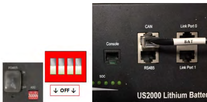
Рисунок 14 – Підключення комунікаційного кабелю до акумуляторної батареї Pylontech
