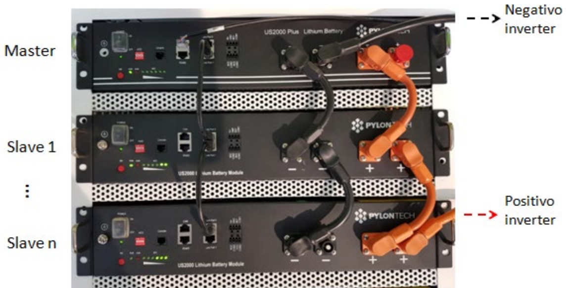
Рис. 10 – Паралельне з'єднання трьох акумуляторних батарей Pylontech
