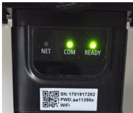
Abbildung 120 - Unregelmäßiger Kommunikationsstatus zwischen Platine und Remote server
