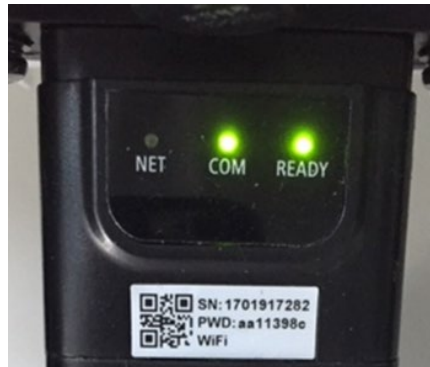
Abbildung 126 – Unregelmäßiger Kommunikationsstatus zwischen Platine und Remote server
