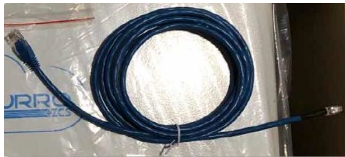
Abbildung 29 - Kommunikationskabel zwischen Inverter und WeCo-Batterie 5K3
