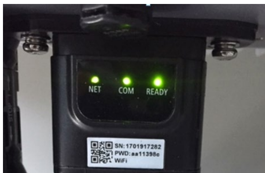
Figure 125 – État final des led
