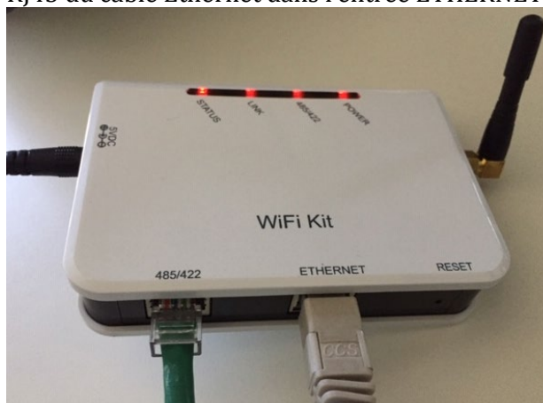
Figure 136 – Câble Ethernet connecté au datalogger
