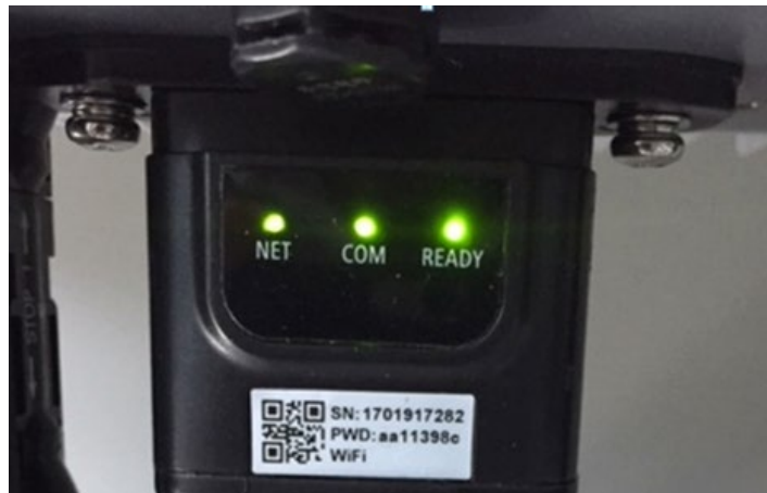
Figure 119 – État final des led
