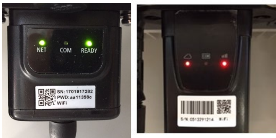
Abbildung 53 - Status unregelmäßige Kommunikation zwischen Inverter und WLAN
