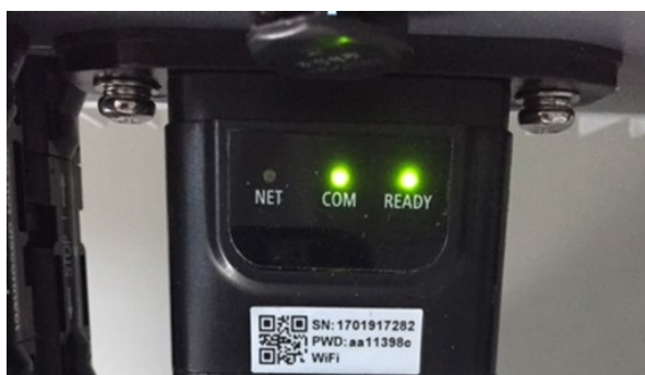
Figura 68 - Estado inicial de los LED
