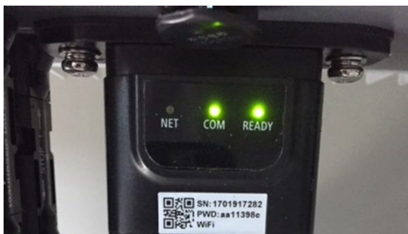
Figura 62 - Estado inicial de los LED
