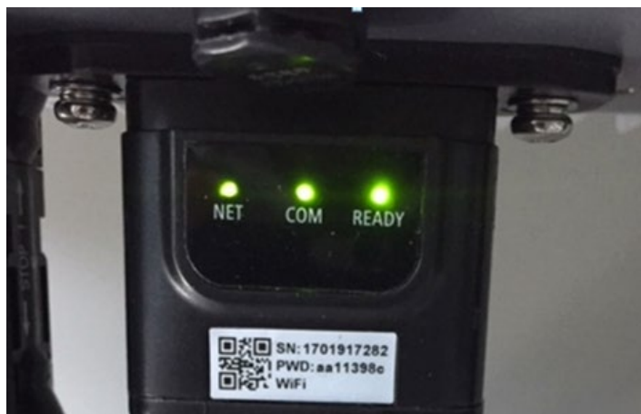
Figura 63 - Estado final de los LED
