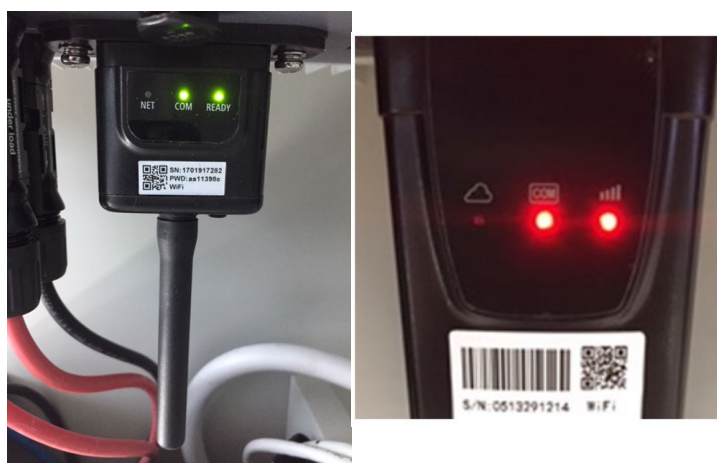
Figura 50 - Estado inicial de los LED
