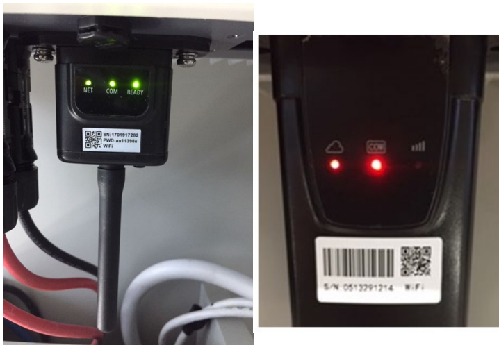
Figura 51 - Estado final de los LED
