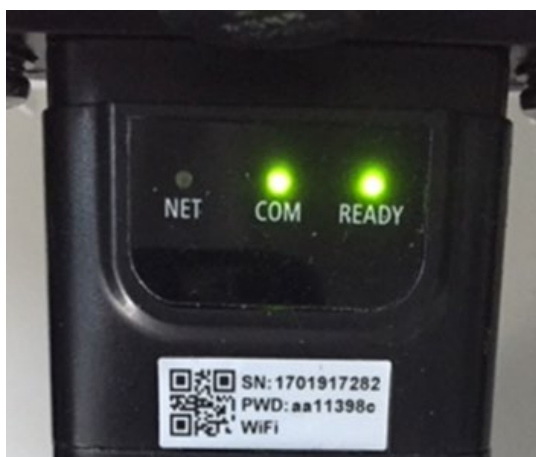
Figura 65 - Estado de comunicación irregular entre adaptador y servidor remoto
