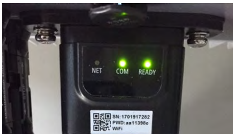
Figura 62 - Estado inicial de los LED
