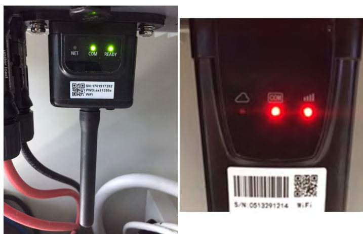
Figura 50 - Estado inicial de los LED
