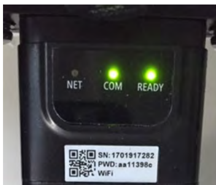
Figura 71 - Estado de comunicación irregular entre adaptador y servidor remoto
