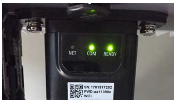
Figura 68 - Estado inicial de los LED
