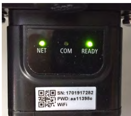
Figura 64 - Estado de comunicación irregular entre inversor y adaptador
