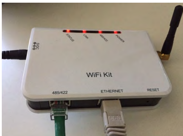
Figura 82 – Cable Ethernet conectado al datalogger
