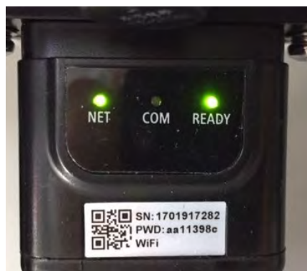
Figura 70 - Estado de comunicación irregular entre inversor y adaptador
