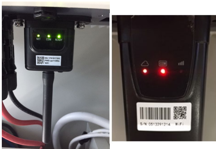
Figure 51 – État final des LED
