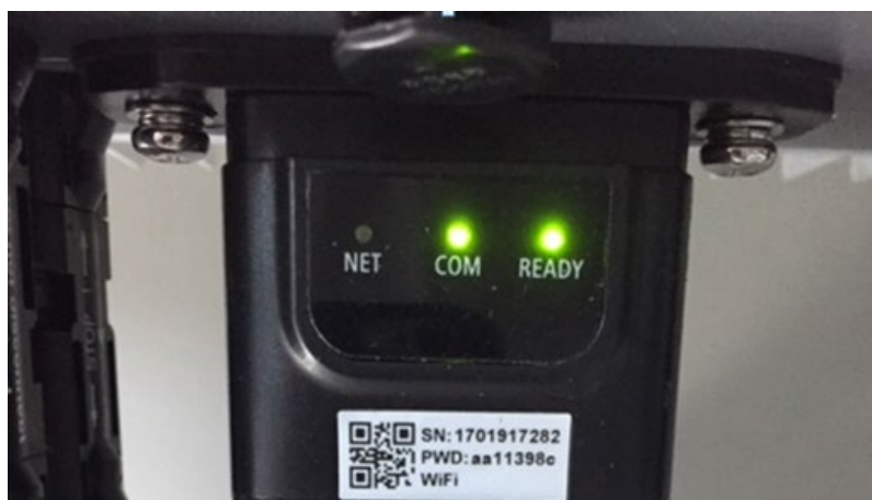
Figure 62 – État initial des LED
