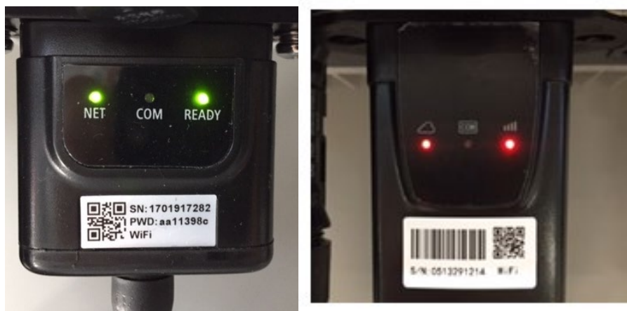
Figure 53 – État de communication irrégulière entre onduleur et Wi-Fi
