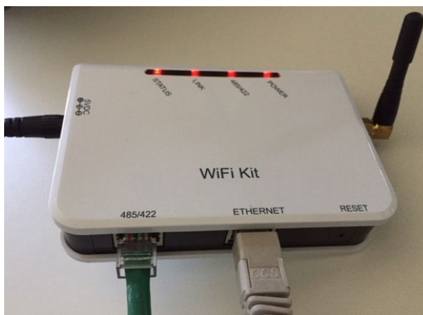
Rysunek 82 – Przewód Ethernet podłączony do rejestratora danych
