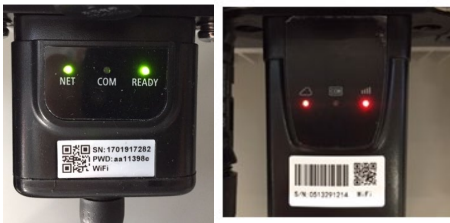
Rysunek 53 - Nieprawidłowy stan komunikacji pomiędzy falownikiem a Wi-Fi
