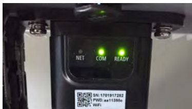
Figura 5-59: Estado inicial de los LED
