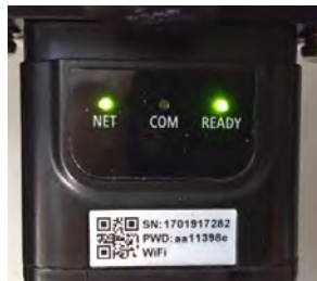
Figura 5-62 - Estado de comunicación irregular entre el inversor y el adaptador
