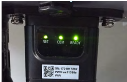
Figure 5-62 - État final des LED
