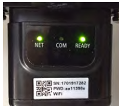
Figure 5-59 - État de communication irrégulier entre le variateur et l'adaptateur
