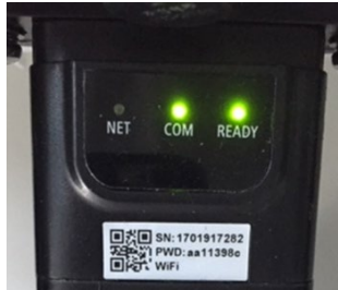
Figura 5-63 - Estado de comunicación irregular entre el adaptador y el servidor remoto
