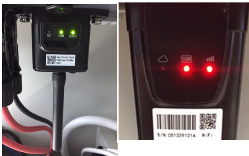
Figura 5-51: Estado inicial de los LED
