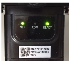
Figura 5-59 - Estado de comunicación irregular entre el inversor y el adaptador
