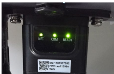
Figura 5-59: Estado final de los LED
