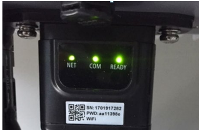
Figura 5-62: Estado final de los LED
