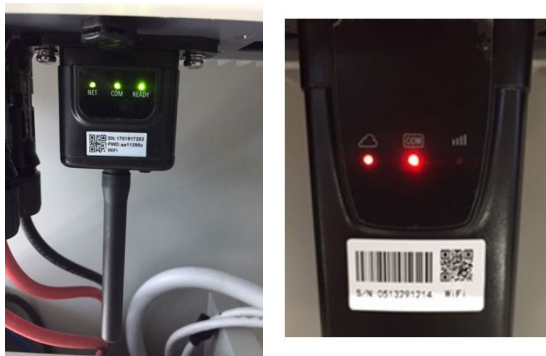
Figura 5-52: Estado final de los LED
