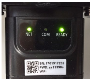
Figura 5-62 - Estado de comunicación irregular entre el inversor y el adaptador
