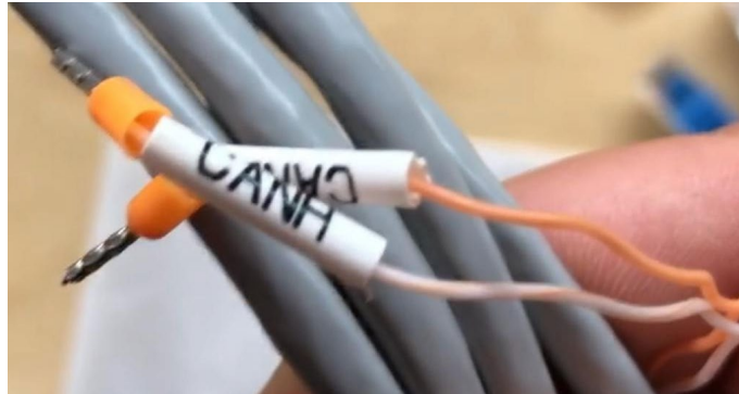
Рис. 81 - Кабель зв'язку інвертор/HV BOX
