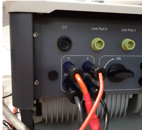
Рис. 148 - Підключення живлення постійного струму на стороні інвертора з подвійним задіяним входом акумулятора
