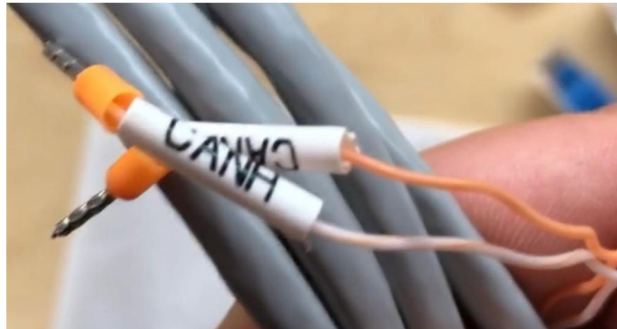
Рис. 105 - Кабель зв'язку інвертор/HV BOX
