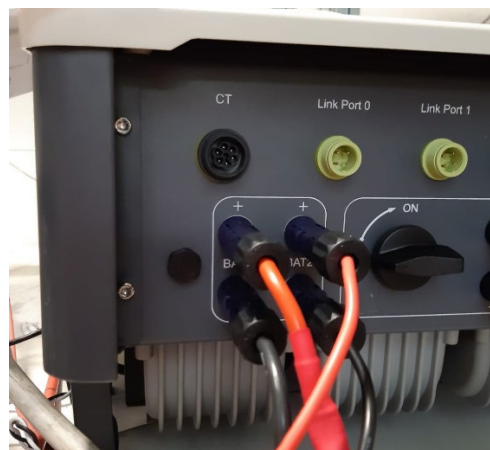
Рис. 78 - Підключення живлення постійного струму на стороні інвертора з подвійним задіяним входом акумулятора
