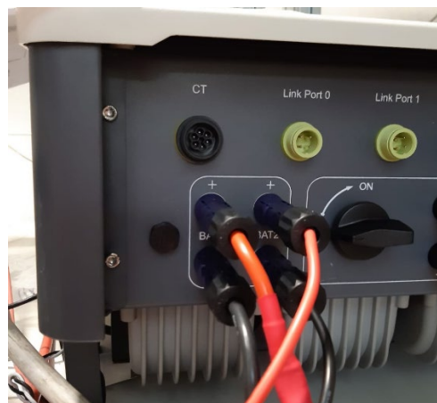
Рис. 101 - Підключення живлення постійного струму на стороні інвертора з подвійним задіяним входом акумулятора
