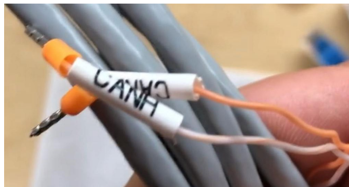
Рис. 93 - Кабель зв'язку інвертор/HV BOX
