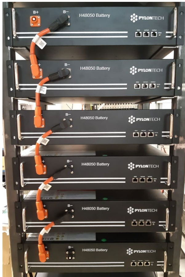
Рис. 42 - Електропроводка між модулями акумуляторних батарей
